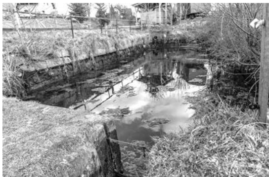
Stav nádrže před zahájením rekonstrukce
